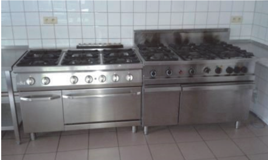
A G: four et cuisinière au gaz A D: four électrique et cuisinière gaz
